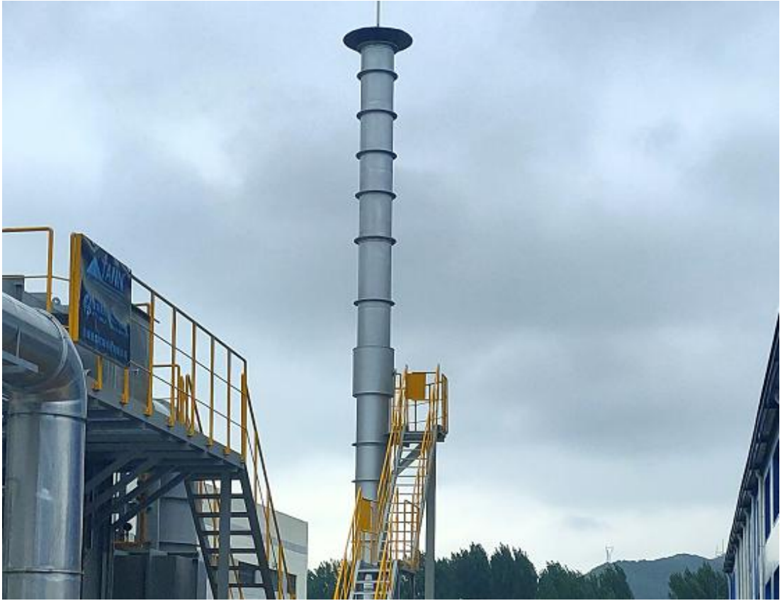
车间废气排气筒
